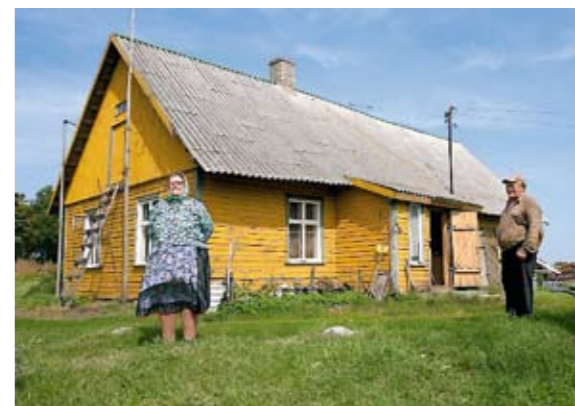
FORFALL: Grunnmur mangler og malingen flasser på hovedhuset på gården Vahtra.
